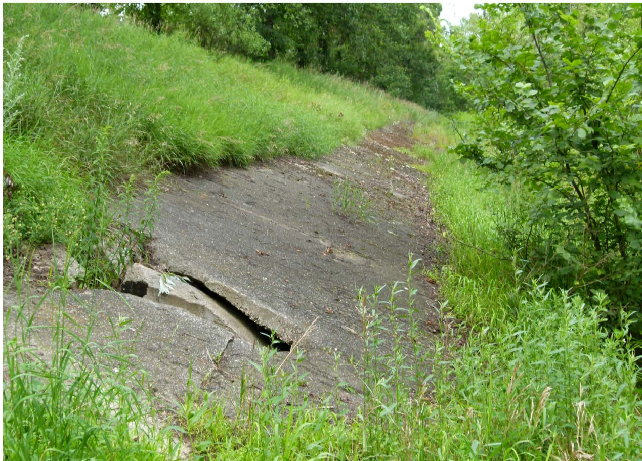
Fot. 6. Niszczące umocnienie dawnego Zalewu Małomickiego
